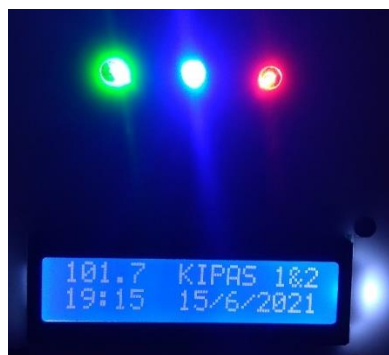
Figure 8. kondisi mesin nyala suhu di atas 95°C
