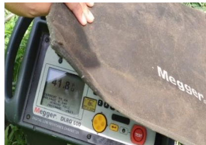
Figure 12. Hasil Pengukuran Tahanan Kontak PMT pada Phasa S.
